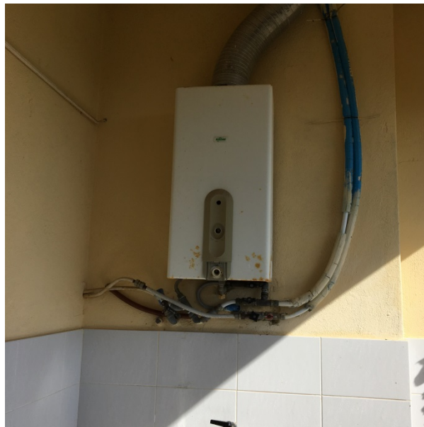
Foto - Caldaia autonoma a GPL
