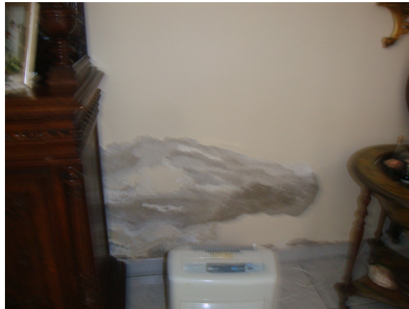
Foto - Macchia d'umidità soggiorno
