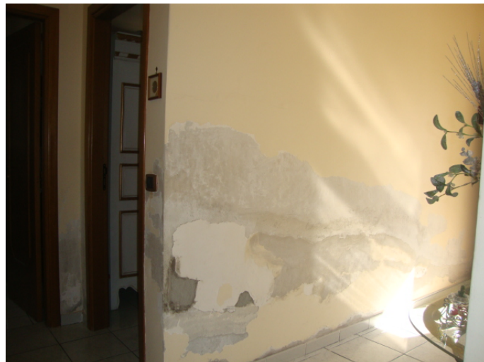
Foto - Particolare macchia d'umidità
