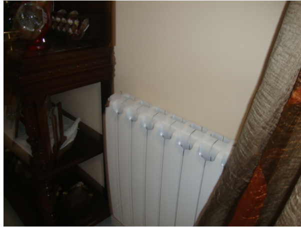
Foto - Particolare elemento dell'impianto di riscaldamento
